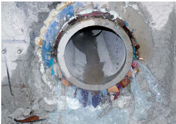
Undichter Ringspalt vor der Injektion
