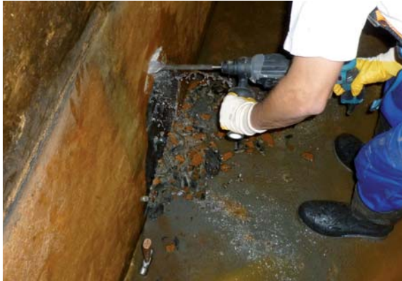
Wassereintritt durch die Wand
