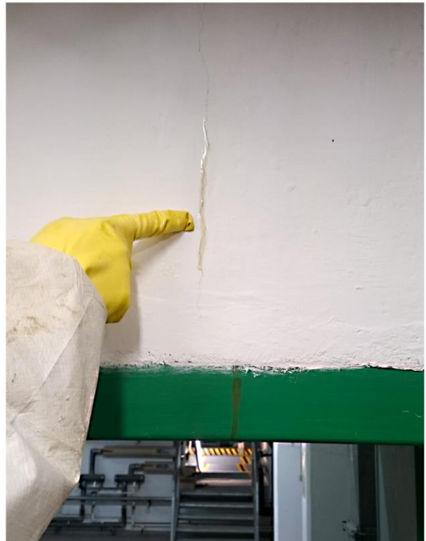
Aufsteigendes Harz im gerissenen Beton
