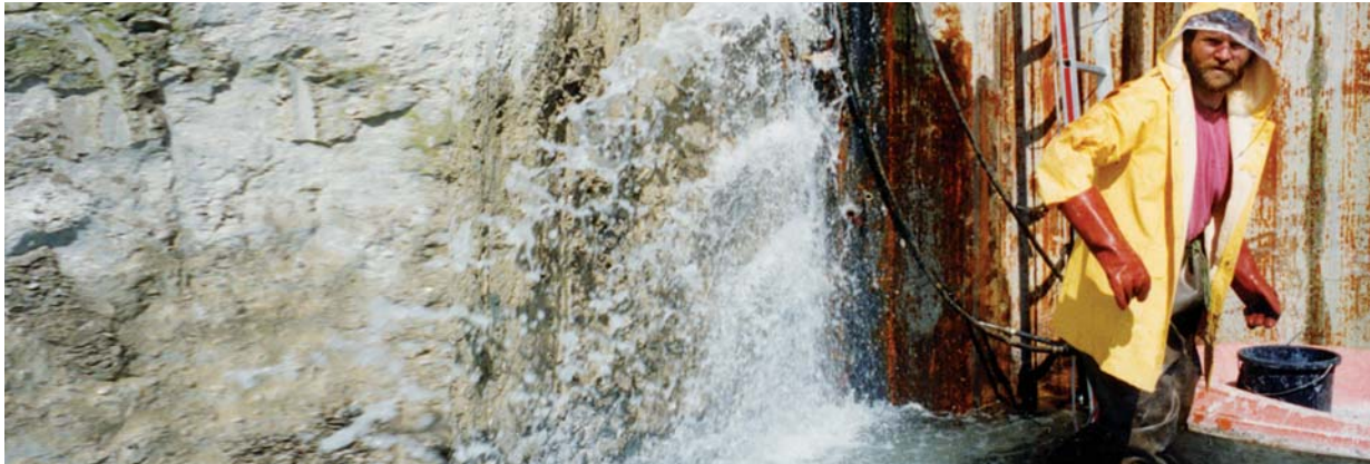
Undichter Anschluß des Überganges Spundwand - Schlitzwand
