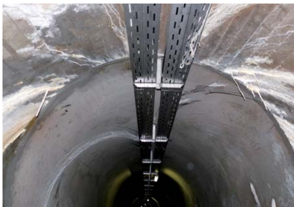
Undichte Arbeitsfuge im Kontrollgang
